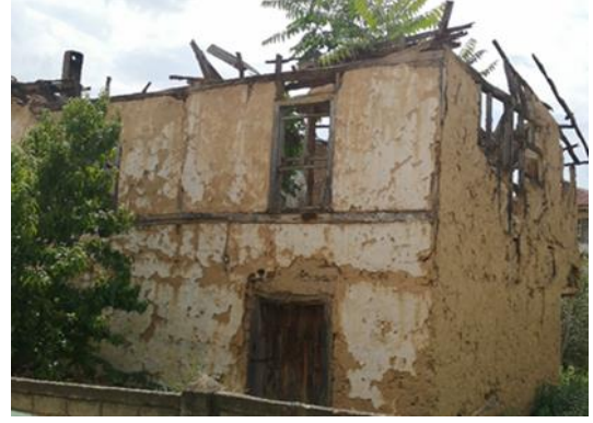
ğekil 4. 7 Çatı hasarları, E012, (Doğan Talyak, 2021)
