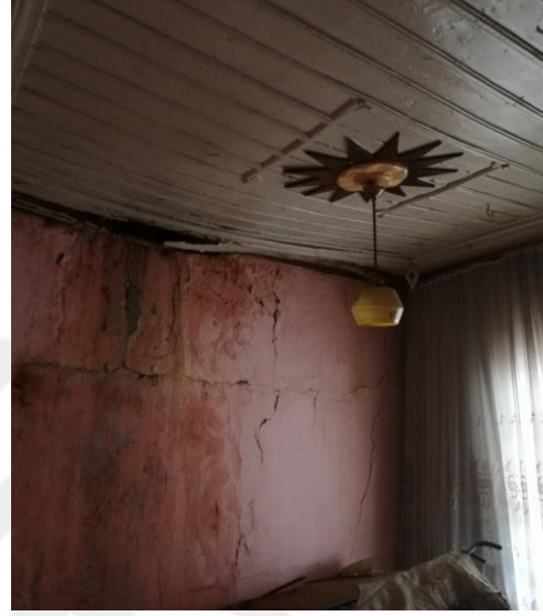
şekil 4. 5 Nem nedeniyle tavan ve duvarda görülen çökme, E017, (Doğan Talyak, 2021)
