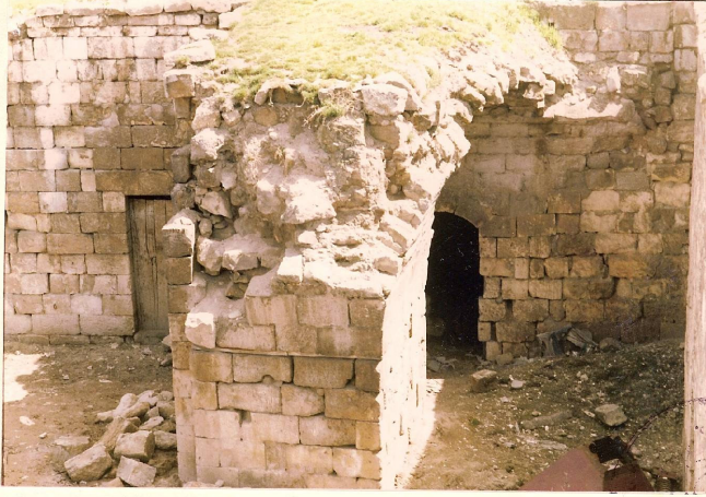
Foto 16- Hanın avluya bakan güney-doğu köşesindeki kısmen yıkılmış kemerin görünüşü. (kemerin devamı daha önce yıkılmış).
