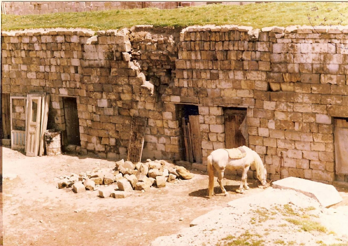
Foto 9- Hanın avluya bakan doğu cephesinde duvardaki yıkıntı.
