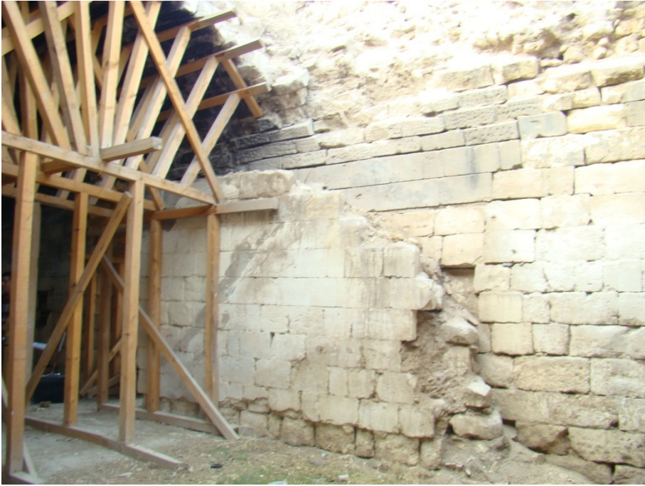
Fotoğraf 4.159 Z56 kuzey duvarına sonradan yapılmış duvar
