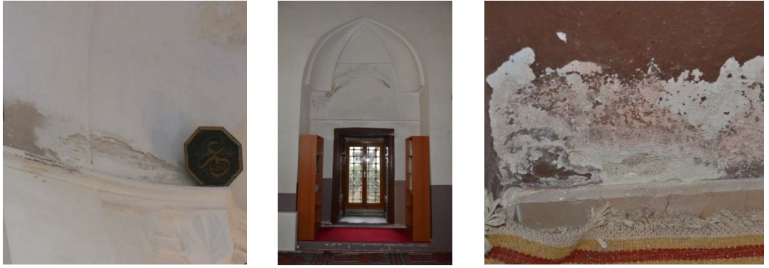
Fotoğraf 3. 132 Caminin Harim ve Esas Harim Bölümlerinde Görülen Hatalı Onarımlara Bağlı Olarak Ortaya Çıkan Tahribat
