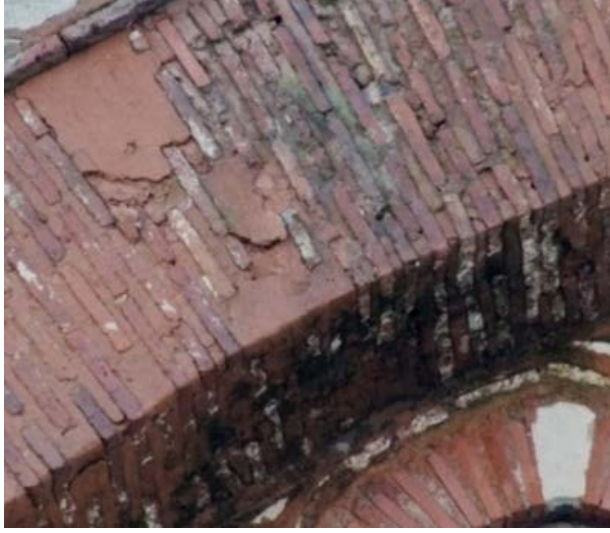
Fotoğraf 3. 146 Doğu Cephede, Büyük Kemerin Tuğlalarında Yosunlanma
