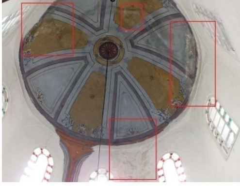
Fotoğraf 3. 134 Türbenin Kubbe Kısımında Suyun Neden Olduğu Bozulma
