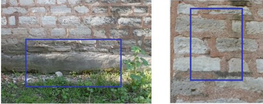
Fotoğraf 3. 22 Güney Cephede, Çimento Harcı İle Yapılan Yalıtım ve Doğu Cephede, Farklı Dönemlerde Yapılan Derz Örnekleri Görülmekte
