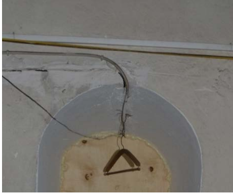
Fotoğraf 3. 119 Güneybatı Yönünde Yer Alan Tabhâne Odasında Görülen Tesisat Kabloları
