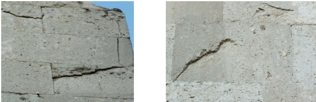
Fotoğraf 3. 140 Minare Kaidesinde Görülen Çatlaklar ve Parça Kayıpları
