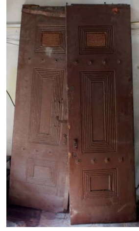
Fotoğraf 3. 109 Özgün Giriş Kapısının Üzerinde Görülen Kalın Boya Tabakası Ve Yıpranmalar
