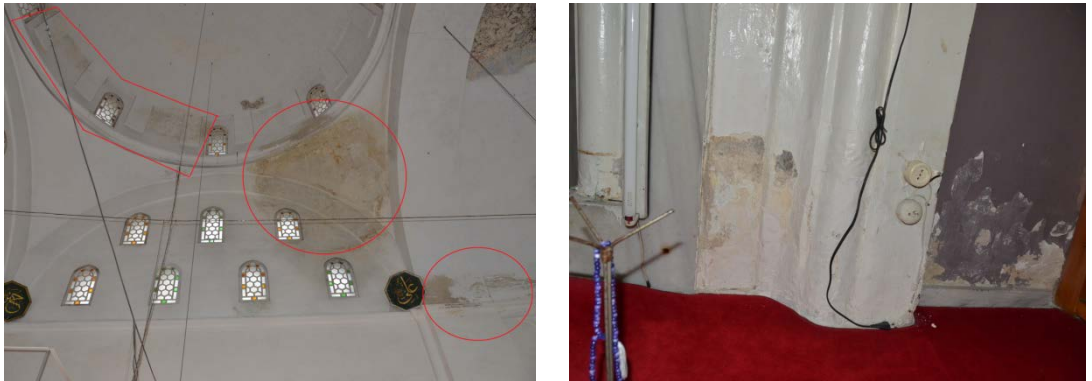
Fotoğraf 3. 133 Çatı Aktarım Sistemlerinin ve Toprak Drenajı Eksikliğinin Neden Olduğu Kısmında Nemlenme ve Buna Bağlı Tahribat
