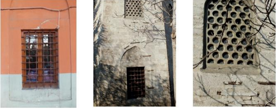
Fotoğraf 3. 21 Caminin Sıvalı ve Boya Giriş Duvarı, Türbenin Batı Duvarında Görülen Onarımlar
