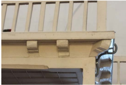
Fotoğraf 3. 110 Kadınlar Mahfilinin Ahşap Elemanlarına Sabitlenmiş Tesisat Kabloları
