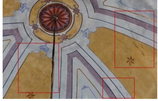
Fotoğraf 3. 135 Türbe Kubbesinde Sıva Çatlaklarının ve Nemlenmenin Neden Olduğu Bozulma
