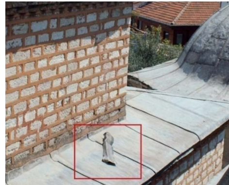
Fotoğraf 3. 127 Güneybatıda Yerinden Çıkmış Üst Örtü Kurşunu
