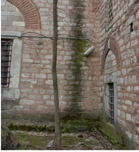
Fotoğraf 3. 144 Güney Doğu Cephede, Nemlenmeye Bağlı Yosunlanma
