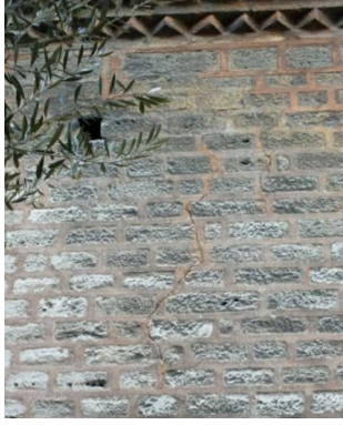
Fotoğraf 3. 129 Güney Cephe Duvarında Görülen Çatlak
