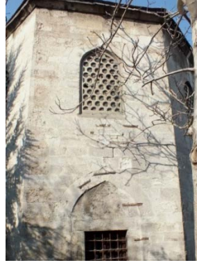
Fotoğraf 3. 130 Türbenin Batı Duvarında Görülen Açılmalar
