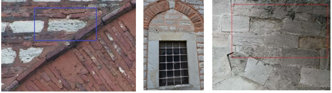
Fotoğraf 3. 125 Caminin ve Türbenin Doğu Cephesinde, Taş ve Tuğla Malzemelerde Görülen Bozulmalar
