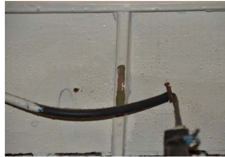
Fotoğraf 3. 111 Kadınlar Mahfilinin Ahşap Elemanlarına Sabitlenmiş Tesisat Kabloları
