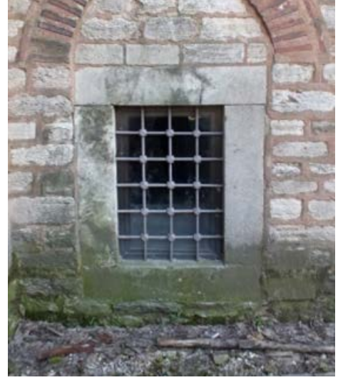
Fotoğraf 3. 147 Güney Batı Cephede Pencere Tabanında Yosunlanma
