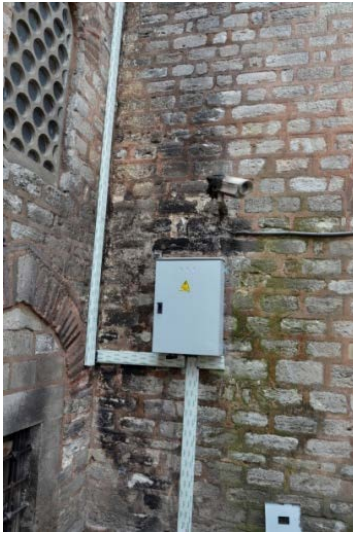
Fotoğraf 3. 115 Güney Batı Yönünde Elektrik Panosundan Çıkan Yangının Sebep Olduğu Tahribat
