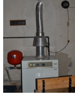
Fotoğraf 3. 120 Güneybatı Yönünde Yer Alan Tabhâne Odasında Görülen Doğalgaz Tesisatı
