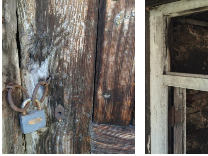
Şekil 2.64. Güneydoğu cephesi kapı ve pencere doğramalarında meydana gelen çeşitli ahşap bozulmaları (bitim katmanı olan boyaların niteliklerini kaybetmesi, dökülmesi, böcek tahribatı, uçma delikleri vb.)
