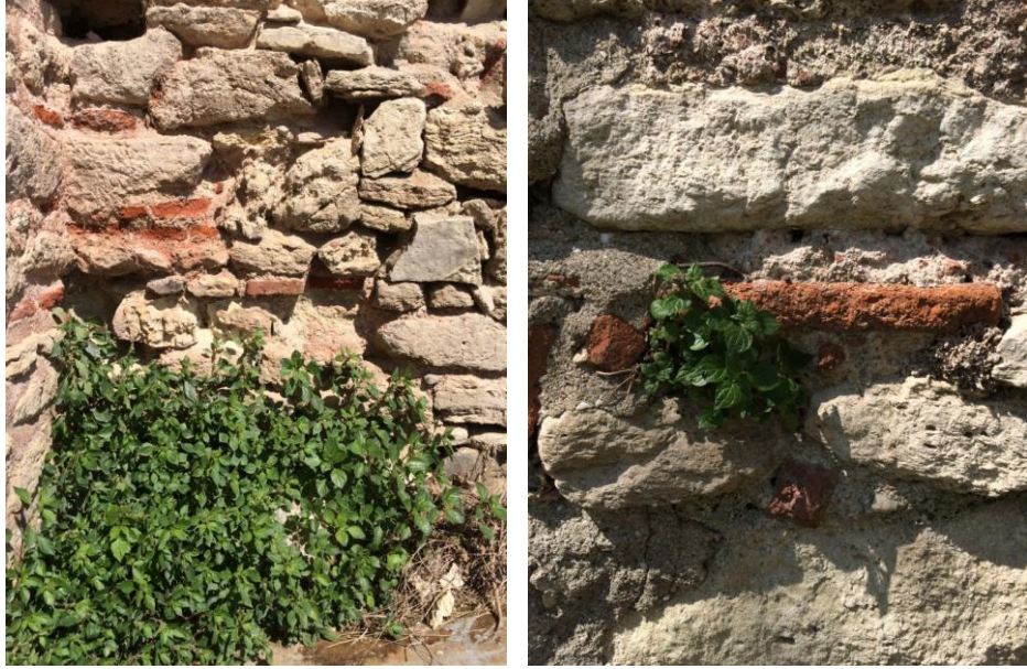
Şekil 2.63. Güneybatı ve güneydoğu cephelerinde duvar bünyelerinde gelişmiş otsu yapıda biyolojik oluşumlar
