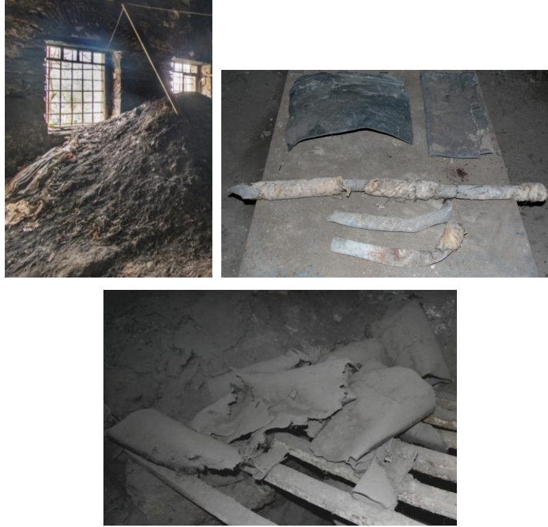
Şekil 2.68. Z01 mekanındaki üretime bağlı birikmeler ve kirlilikler (moloz, kurşun kalıntıları, cüruf vb.)
