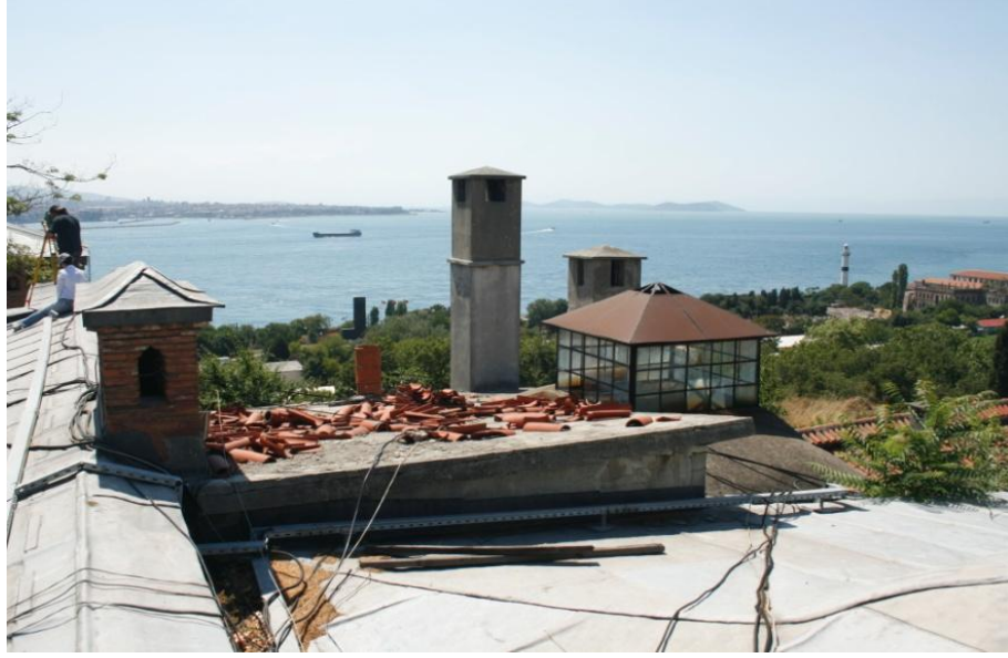
Şekil 2.70. Örtü sisteminde gerçekleştirilmiş niteliksiz müdahaleler (Tures Turizm Planlama ve Restorasyon San. ve Tic. Ltd. Şti. Arşivi, 2009)
