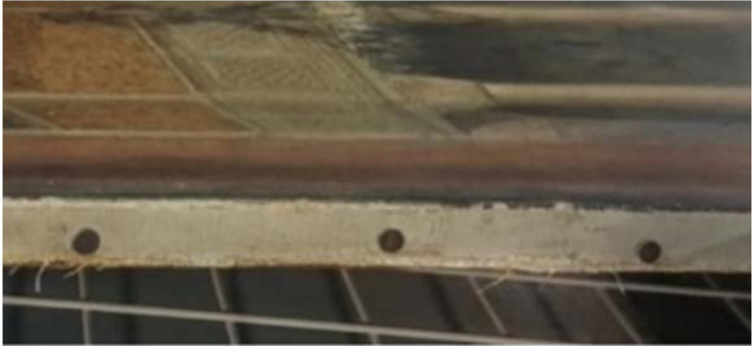
Resim 4.23 Ayasofya Camii Hünkar Mahfili ; genel ışık altında çivi kenarından detay görünüm.
