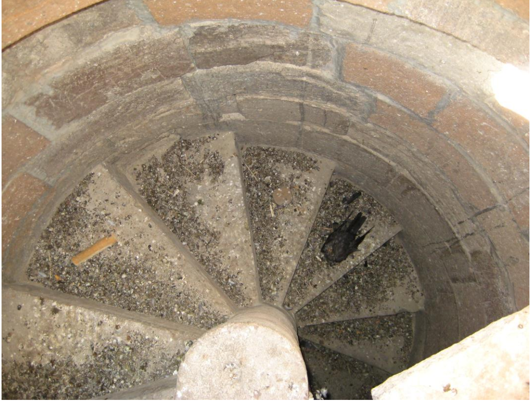
Fotoğraf 185: Minare içindeki kuş pislikleri ve ölüsü
