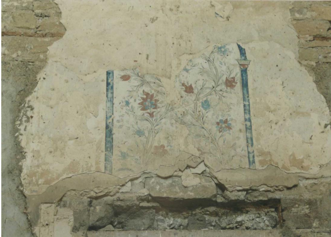
Fotoğraf 230: Boya tabakası üzerinde oluşan tül tabakası (N. Mercan)
