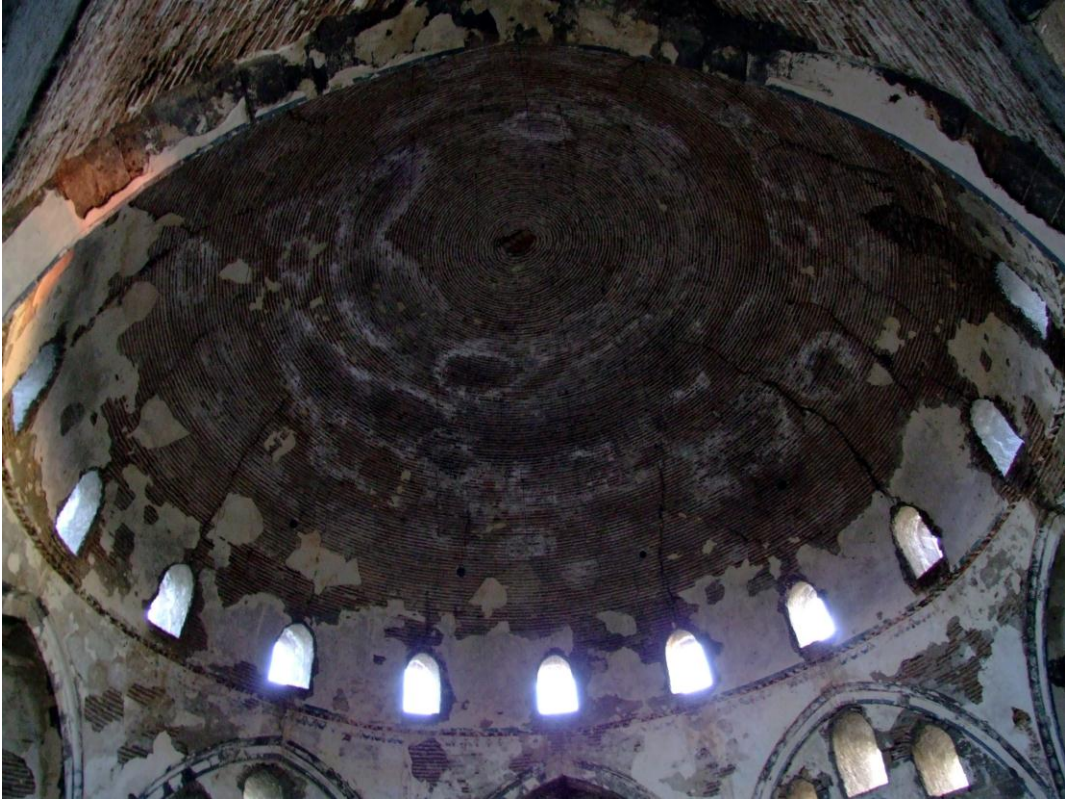
Fotoğraf 170: Kubbede yer alan çatlaklar (Ş. Öztürk)
