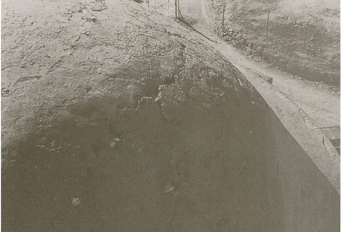
Fotoğraf 86: Onarım öncesi, cami kubbesindeki çatlaklar (Uluçam–Kavaklı)
