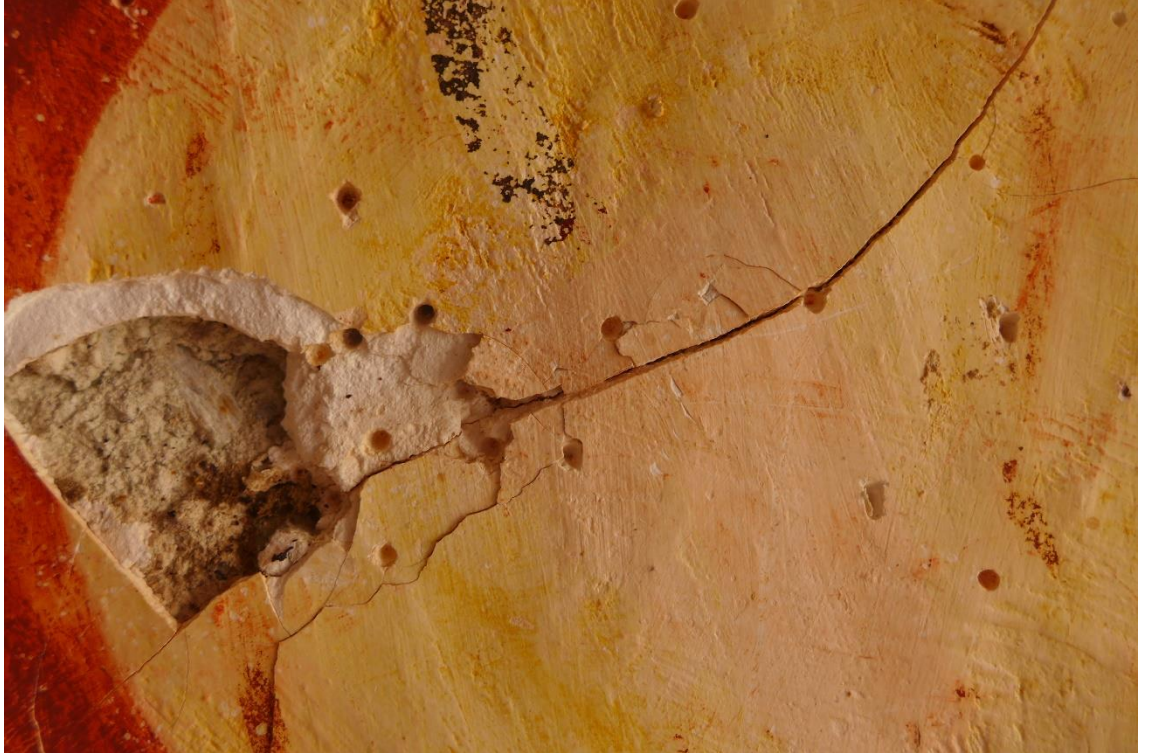
Şekil 2.9 Kızılçukur Vadisi Üzümlü Kilise'de Sıva Tabakasında Görülen Çatlaklar
