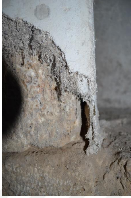
Şekil 2.8 Niğde İli Bor İlçesi'nde Bulunan Ermeni Kilisesi (Cığızoğlu Konağı) Duvar Resimlerinde Sıva Tabakasında Ayrışma ve Ayrılmalar
