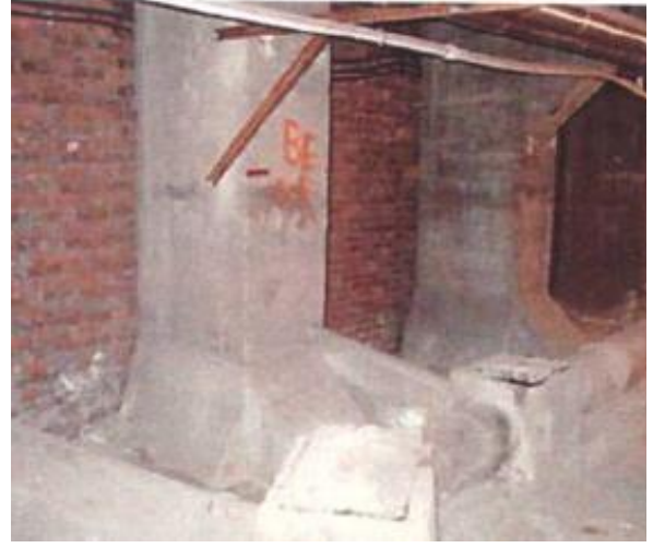
Resim 3-33 Fen Fakültesi Bodrum Kat Taşıyıcı Bölme Duvar (İTÜ Mimarlık Fakültesi Yapı Malzeme Laboratuvarı, 2011)
