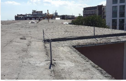
Resim 4-94 Çatı Sökümü Sonrası ortaya çıkan betonarme döşeme (İhale Dosyası, 2013)
