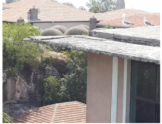
Resim 4-93 Söküm Sonrası korozyona uğrayan demirler ve beton saçağın durumu (İhale Dosyası, 2013)
