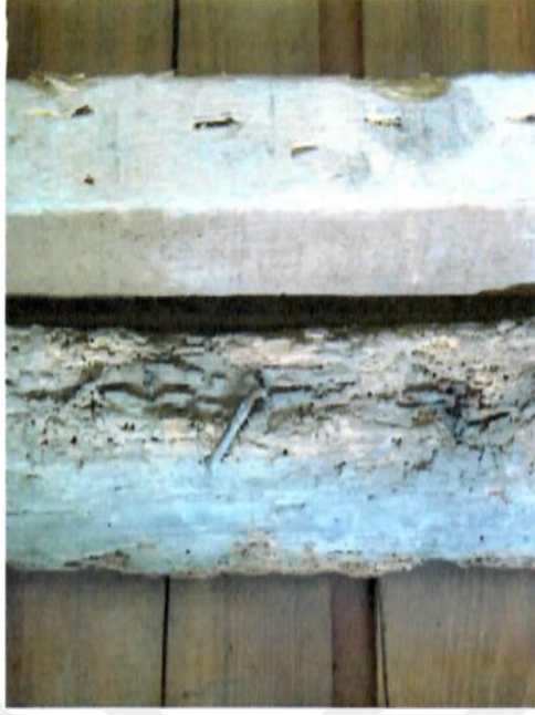
Şekil 5.22: HSY Taşıyıcı Sistemdeki Mantarlaşmalar ve Böceklenmeler 5
