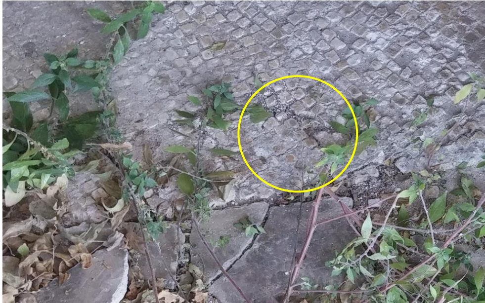
Şekil 5. 4 A.E. 36, Çatlak Örneği 2017 (P.K.A)
