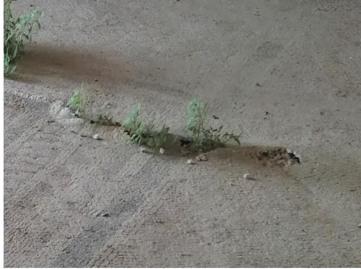
Şekil 6. 18 A.E. 36, Bitkisel gelişim görülen yerde oluşan lakuna, tessera dağılması, kabarma oluşumu (2017) (P.K.A)
