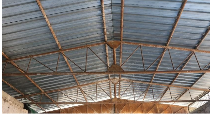
Şekil 4. 8 A.E. 36, Korozyona Uğramış Demir Çatı İskeleti (2020) (P.K.A)
