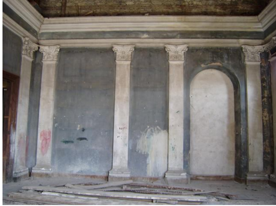
Fotoğraf 193 “A.1K.05” No.lu mekân kuzey duvarındaki niş
