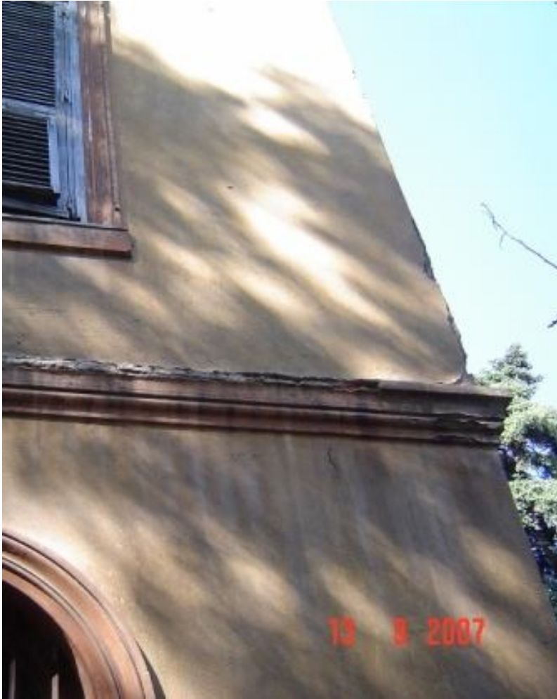
Fotoğraf 142 -0,26 kotu kat silmesi
