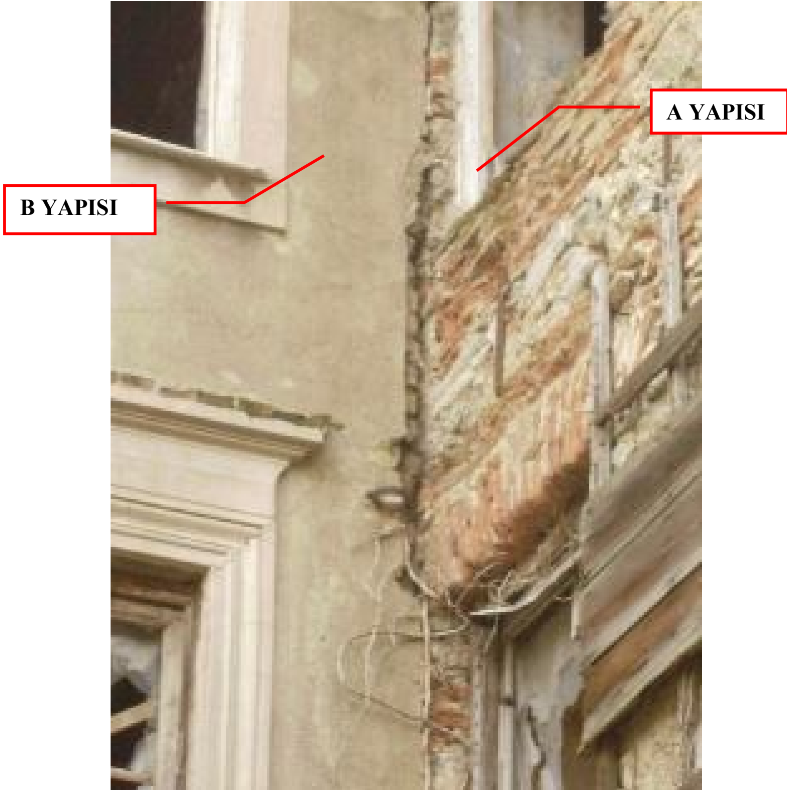
Fotoğraf 175 - A ve B yapıları arasında Batı cephesinde görülen derz.
