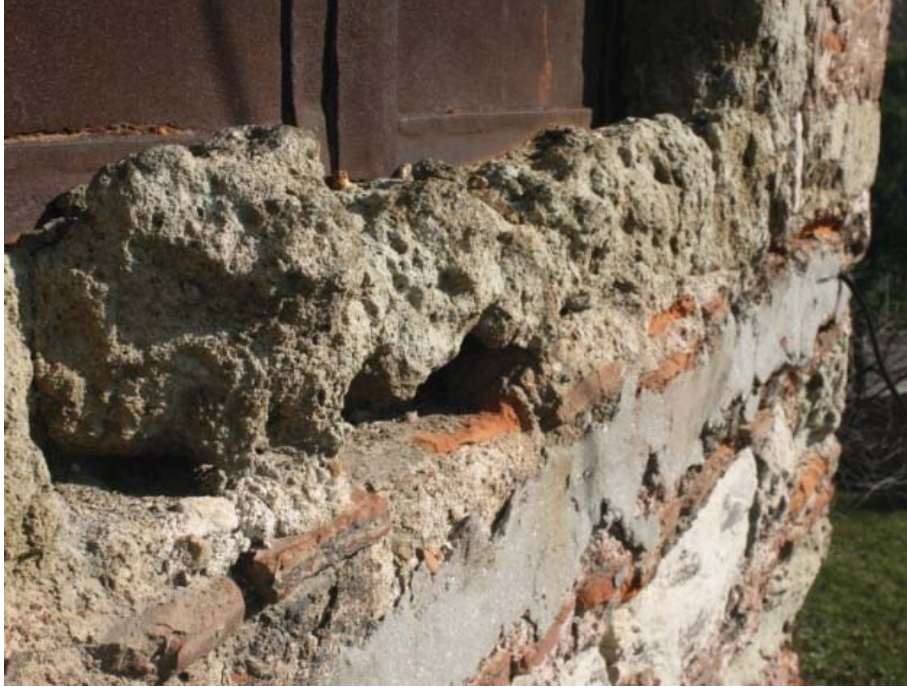
Fotoğraf 4.19. Yapının güneybatı cephesinde yer alan metal kepenkli pencere denizliğindeki değiştirilmesi gerekli olan tuf taşı
