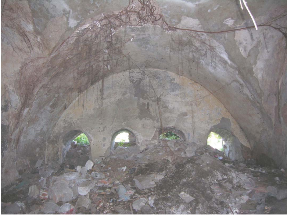
Fotoğraf 2.27. Zemin kat içerisinde yer alan, pencere seviyesine ulaşmış dolgu ve molozlar
