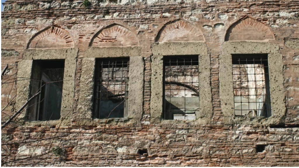
Fotoğraf 4.9. Korozyona uğramış olan parmaklıkların kısmen varlıklarını sürdürdükleri ancak oldukça hasarlı oldukları görülmektedir
