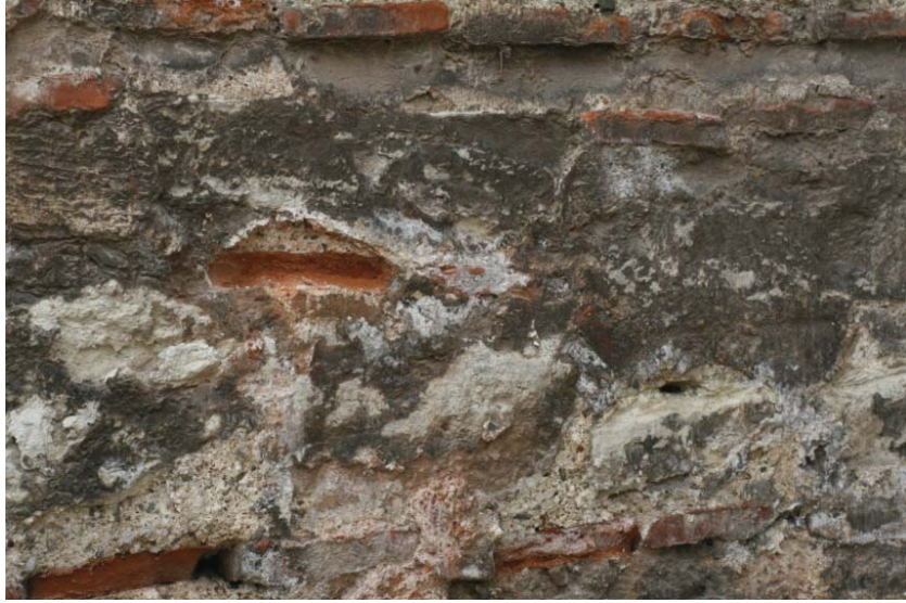
Fotoğraf 4.17. Yapının güneydoğu cephesinde oluşmuş olan alçıtaşı kirlilikler
