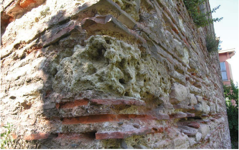
Fotoğraf 4.20. Yapının güneydoğu cephesinde görülen derz boşalmaları ve bozulmuş durumda olan tuf taşı
