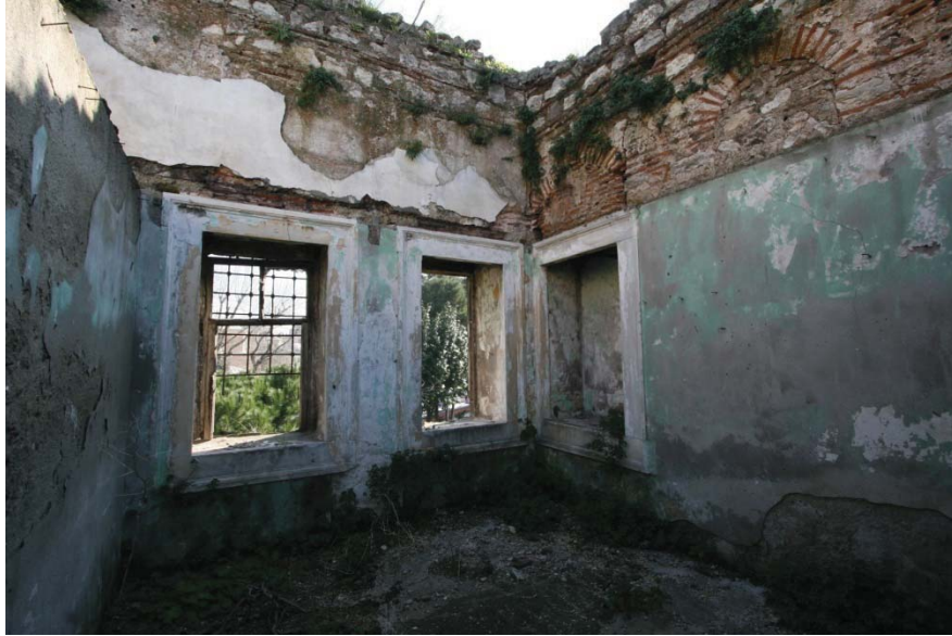
Fotoğraf 4.2. Yapının birinci katında yer alan muhdes duvarların yanı sıra orijinal duvarlara da çimento sıvalar uygulandığı görülmektedir.
