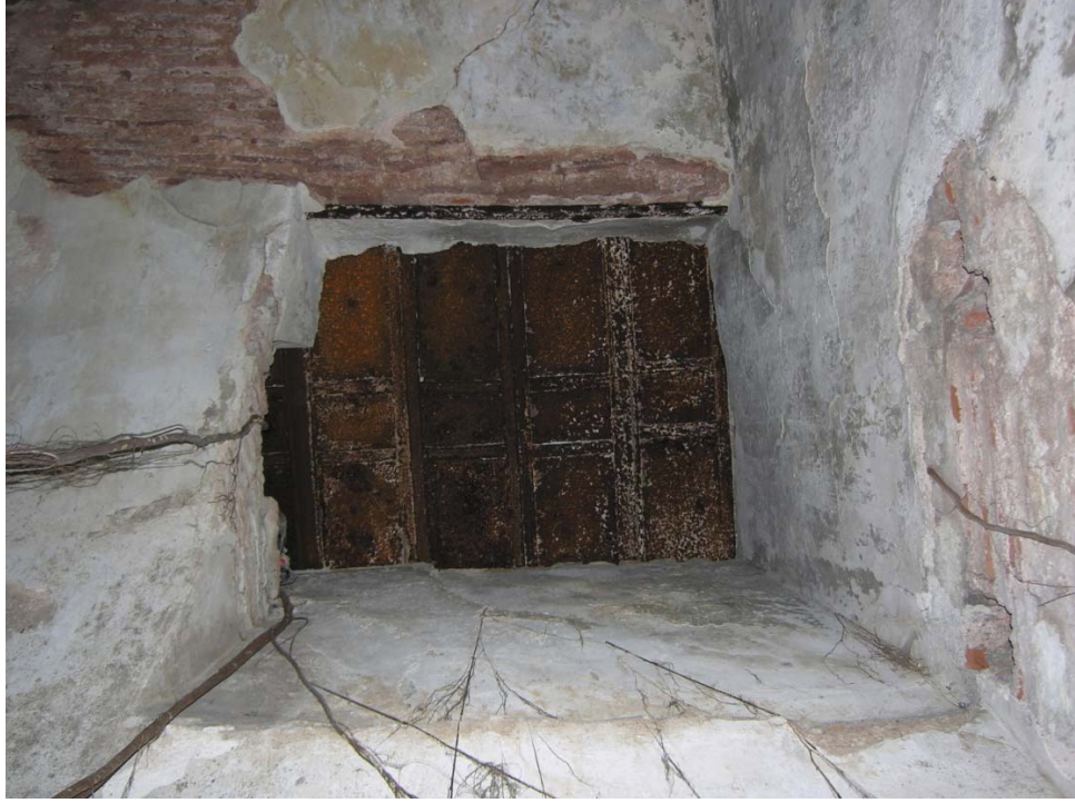
Fotoğraf 2.9. Merdivenin uzandığı üst kat zemininin metal kepenkler ile kapatıldığı görülmektedir.
