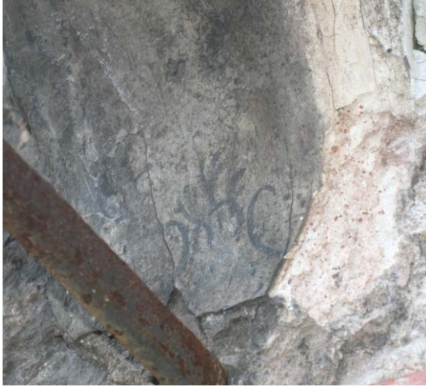
Fotoğraf 2.10. Birinci katta kısmen dökülmeden kalmış sıvaların üzerinde görülen bezemeler
