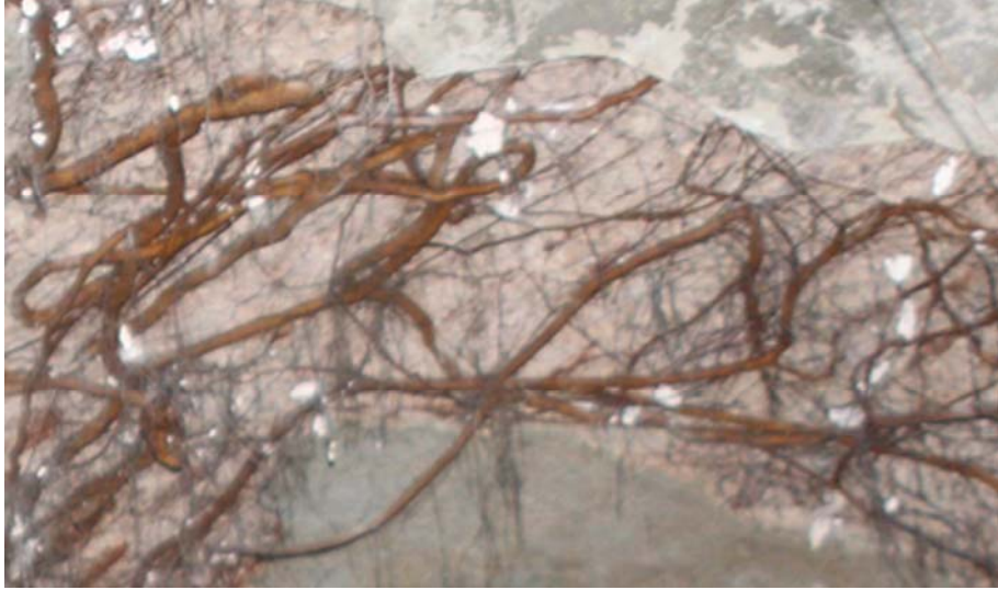
Fotoğraf 4.6. Yapının zemin katında, sıvaların arkasına kadar ilerlemiş olan bitki kökleri
