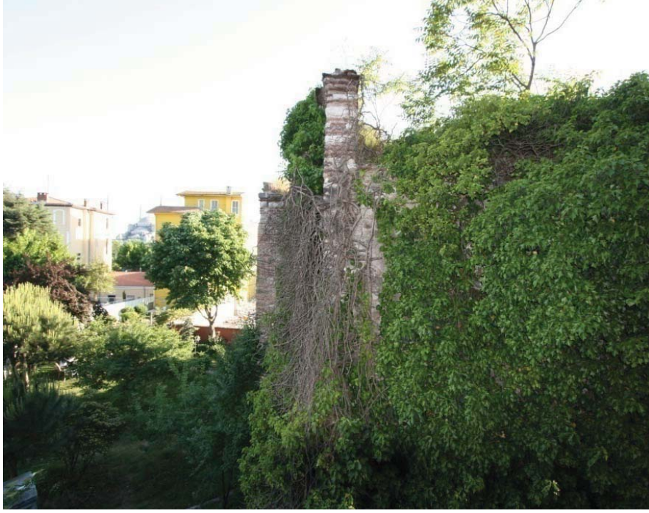
Fotoğraf 4.5. Yapının kuzeydoğu cephesini tamamen kaplamış olan bitkiler
