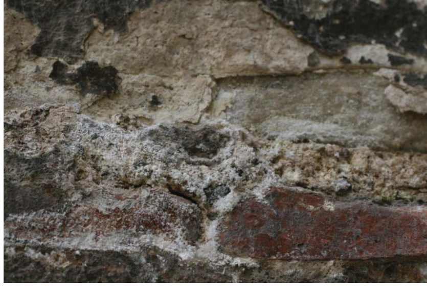
Fotoğraf 4.18. Yapının güneydoğu cephesinde oluşmuş (kabuklanma) alçıtaşı kirlilikler ve yüzeyde birikmiş olan tuz kristalleri
