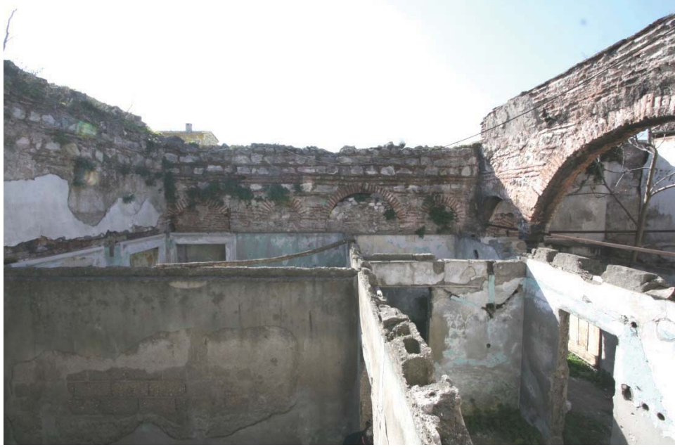
Fotoğraf 2.25. Yapının birinci katında yer alan muhdes bölücü duvarlar
