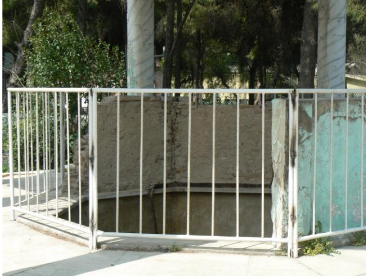
Resim 65: Korkuluk duvarının 2011 yılındaki durumu. (Eda Kavakdipli)
