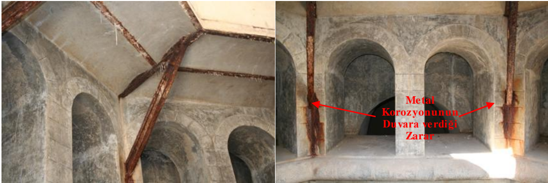
Resim 92: Aşırı korozyona uğramış çelik payanda ve kirişler. (Boygaz Özlen)
