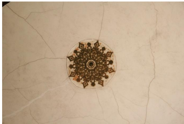
Resim 84: Tavan sıvasında bulunan çatlaklar. (Eda Kavakdipli)
