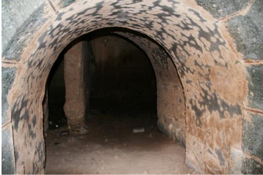
Resim 74: Yeşil andezit kaplamalı kemerlerde liken oluşumu. (Boygaz Özlen)
