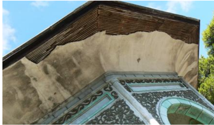
Resim 83: Sıvası dökülmüş çatı eteğinde ortaya çıkmış bağdadi kaplama. (Fotoğraflar: Eda Kavakdipli)
