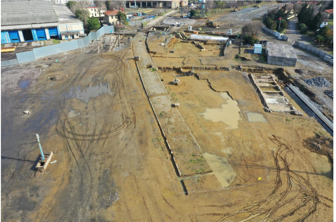
Fotoğraf D.20: Ray hattı güzergahı üzerinde açığa çıkarılan Osmanlı Dönemi yol kalıntısı (04.02.2020)
