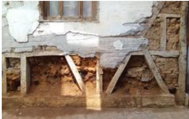
Şekil 4.8. Kerpiç Tuğla ve Ahşapta Bozulma (Y158)
