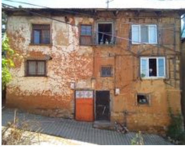
Şekil 4.3. Cephe Programına Müdahale (Y44A-B)
