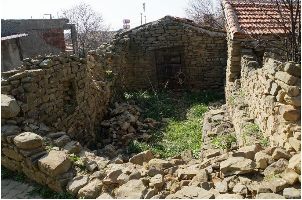
Şekil 5.38 Çatısı ve duvarları yıkılmış ahır-mağaza yapısı, 193 ada 4 parsel (Uçar, 2020).
