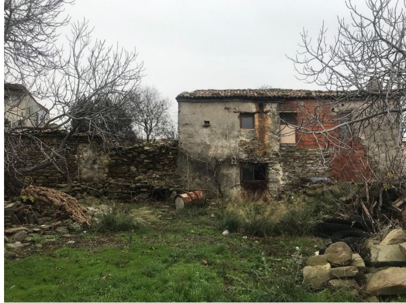
Şekil 5.125 Yığma moloz taş cephe duvarında, delikli tuğla ile yapılan onarım nedeniyle, yapısal hasar meydana gelmiş yapı, 195 ada 3 parsel (Uçar, 2021).
