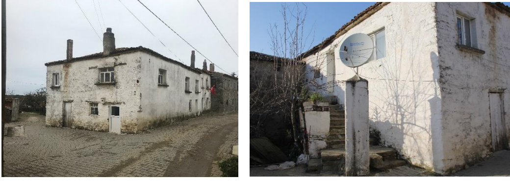
Şekil 5.82 Solda, 179 ada 8 parselde bulunan yapının kuzeydoğu cephesi ve köşe çalığı, sağda, güneybatı giriş cephesi (Uçar, 2020).
