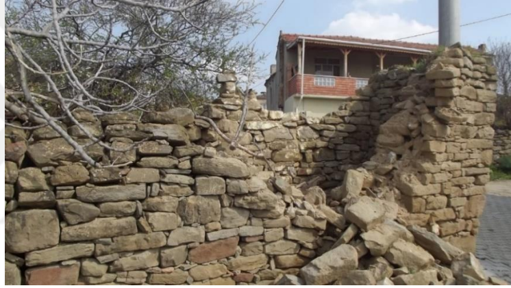
Şekil 5.43 Parsel duvarına bitişik, yıkılmış hela yapısı, 181 ada 5 parsel (Uçar, 2020).
