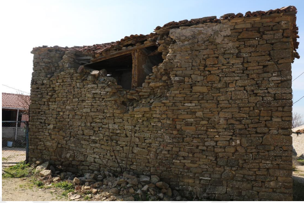
Şekil 5.140 Yığma moloz taş yapı duvarında meydana gelen yapısal hasar, 183 ada 9 parsel (Uçar, 2021).
