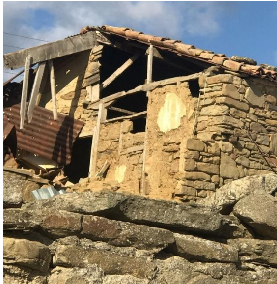
Şekil 5.63 Üst kat çatkılı dış duvarı yıkılmış olan yapı, 177 ada 2 parsel (Uçar, 2020).
