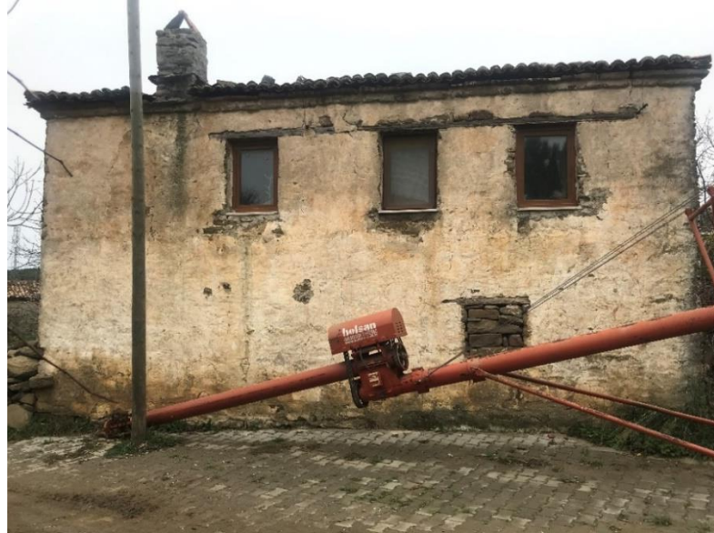
Şekil 5.134 Üst kat pencereleri pvc doğrama ile değiştirilen yapı, 195 ada 3 parsel (Uçar, 2021).
