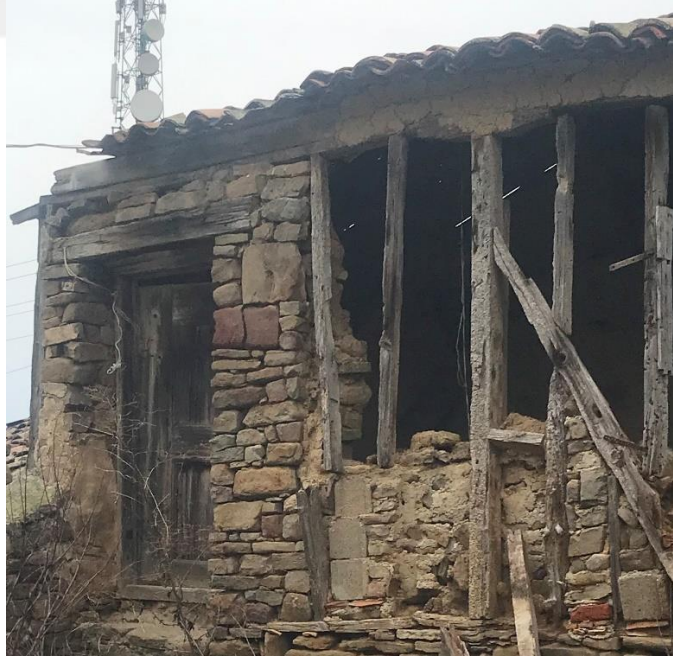
Şekil 5.107 Dış cephe duvarı çatkılı duvar olan yapının saçak altında görünen çamur sıva, 177 ada 5 parsel (Uçar, 2021).
