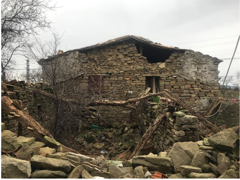
Şekil 5.142 Yıkılan dam ile yapısal hasara uğramış yapı duvarı, 195 ada 3 parsel, (Uçar, 2021).
