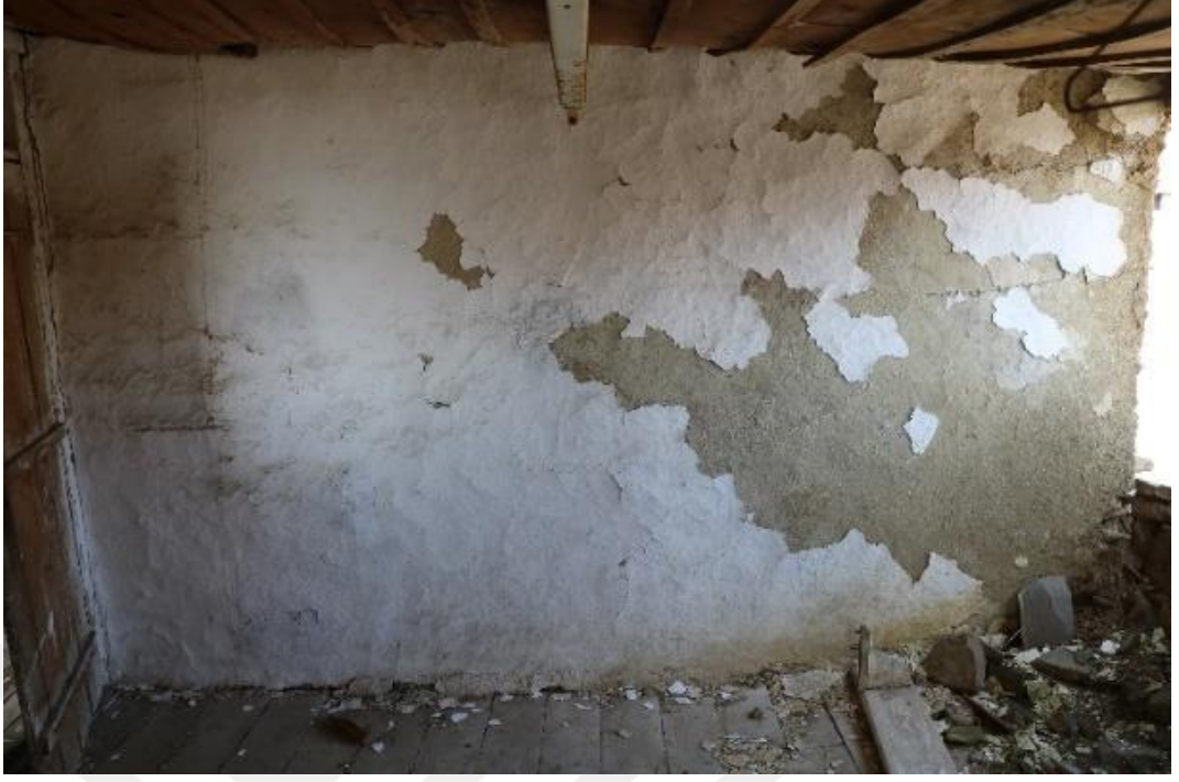
Şekil 5.70 Çamur sıva üstü kireç sıvalı çatklı duvar, 177 ada 4 parsel (Uçar,2021).
