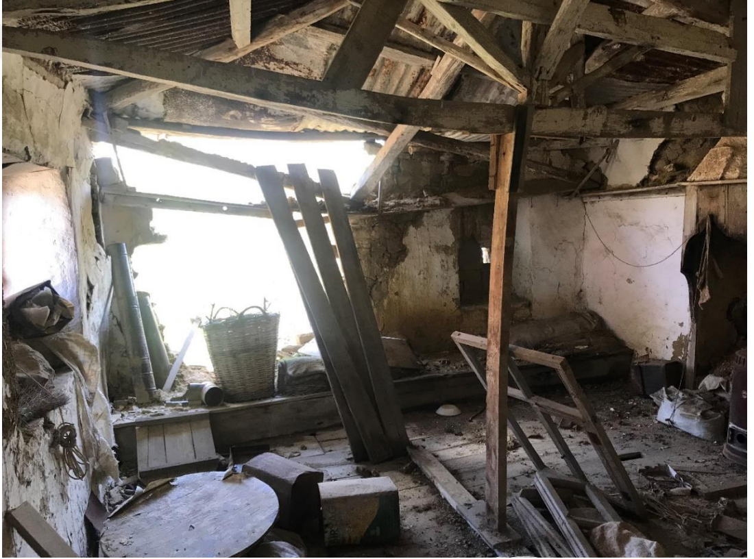
Şekil 5.33 Metruk bir evde tespit edilen sedir, 191 ada 1 parsel (Uçar, 2020).
