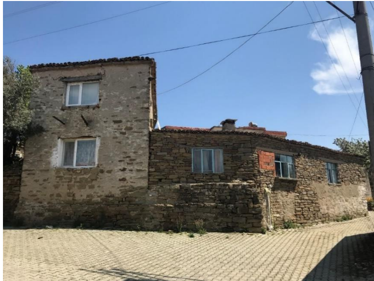
Şekil 5.55 Solda derz dışarı taşarak uygulanmış, sağda cephe sıvasız derzli yapılmış uygulama, 190 ada 7 parsel (Uçar, 2020).
